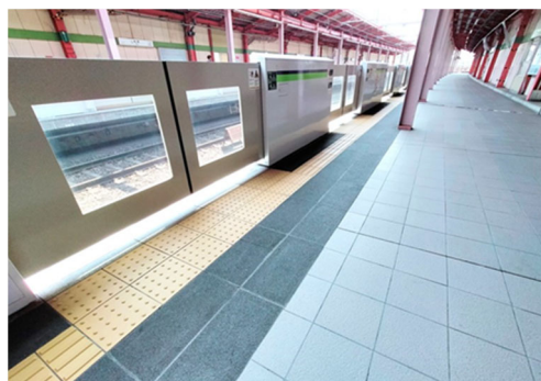
船堀駅ホームドアと視覚障害者誘導用ブロック
