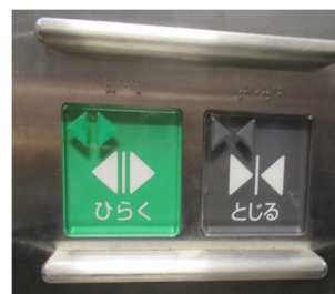
西葛西駅 エレベーター操作盤
