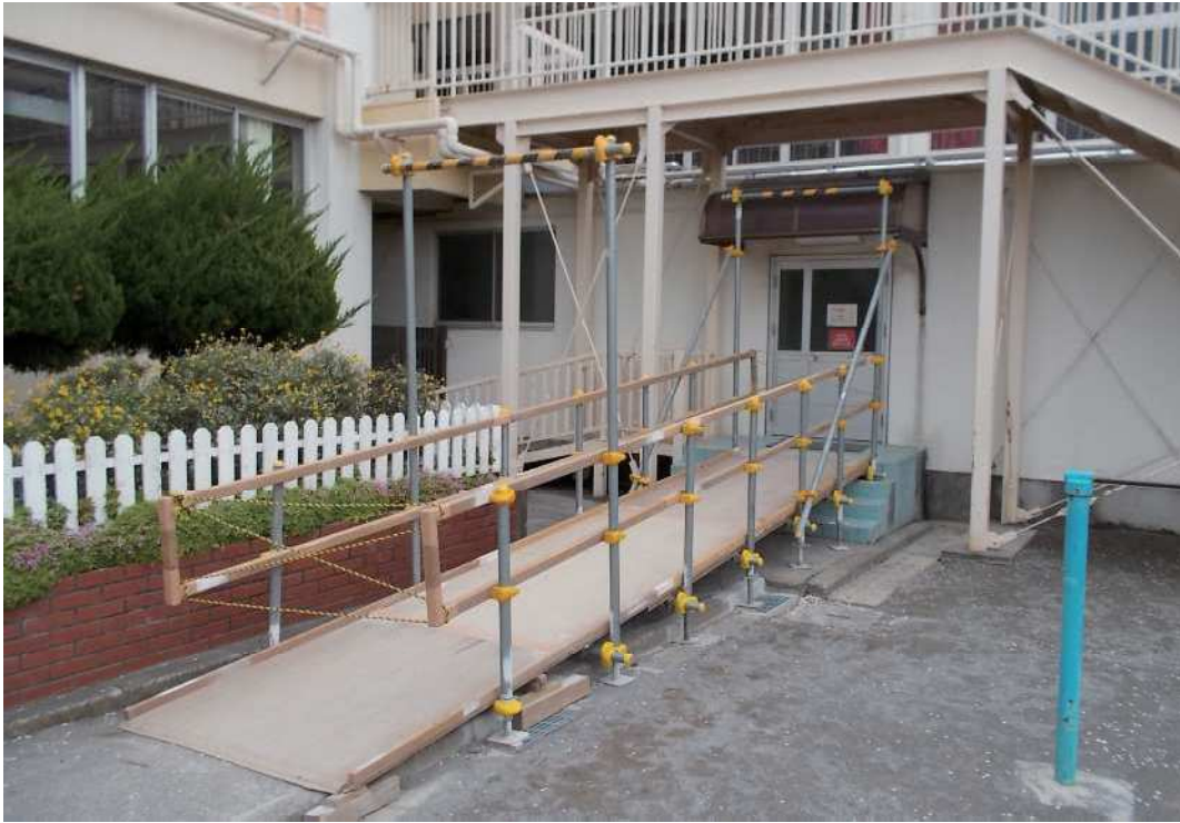
仮設スロープ（第18投票所 一之江小学校）
