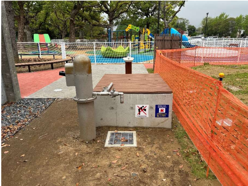
【貯水槽とハンドポンプ】
