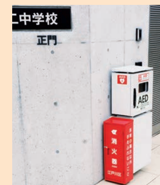
▲施設の屋外に設置している消火器
