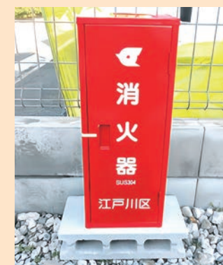
▲地域に設置している消火器
