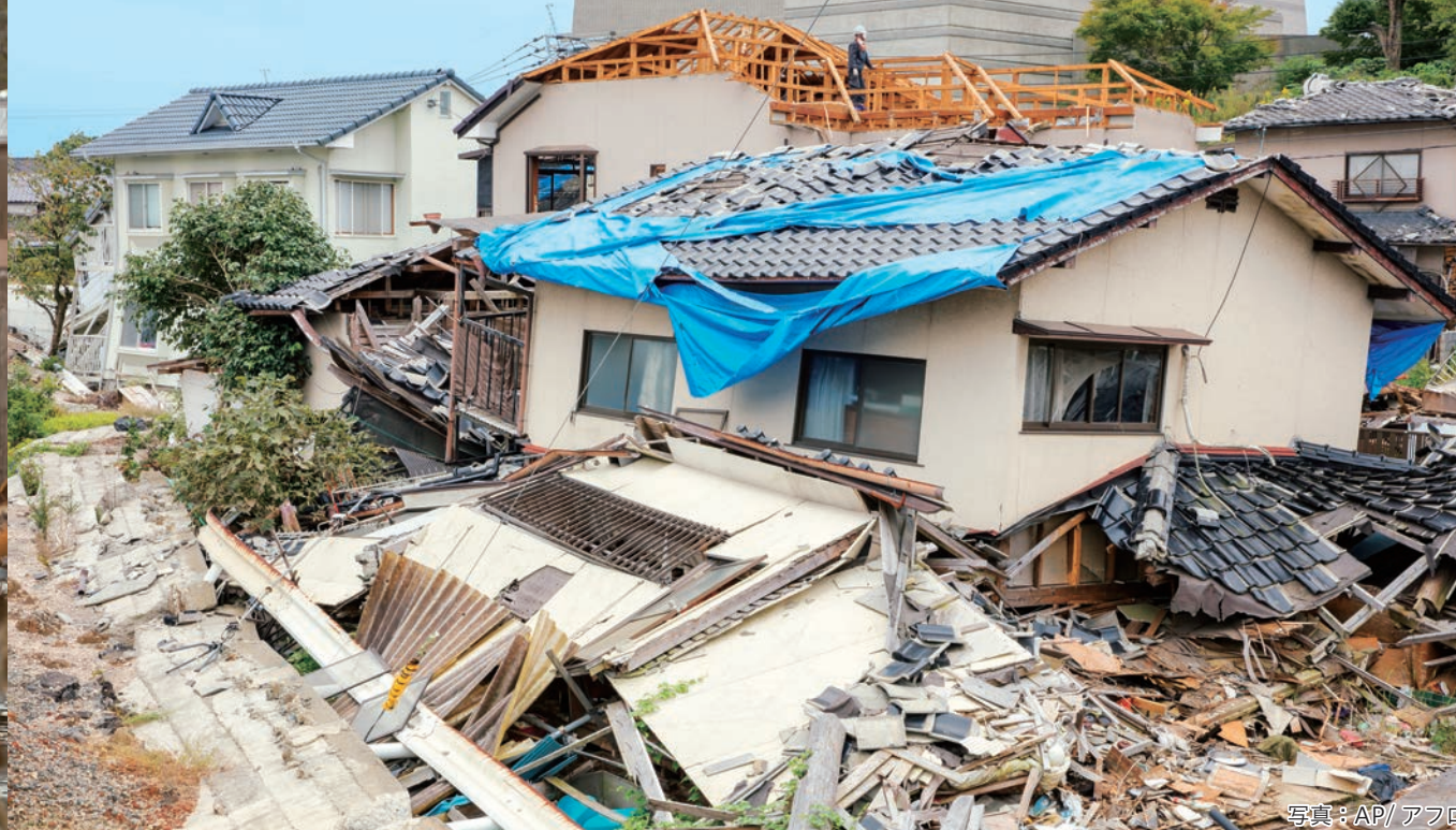
▲令和8年熊本地震で倒壊した家屋
