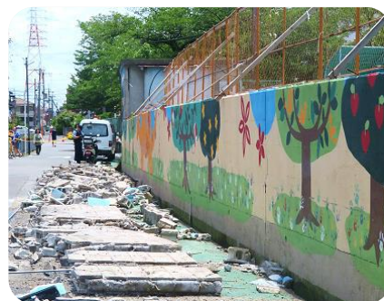
地震により倒壊したブロック塀 (平成30年大阪北部地震)
