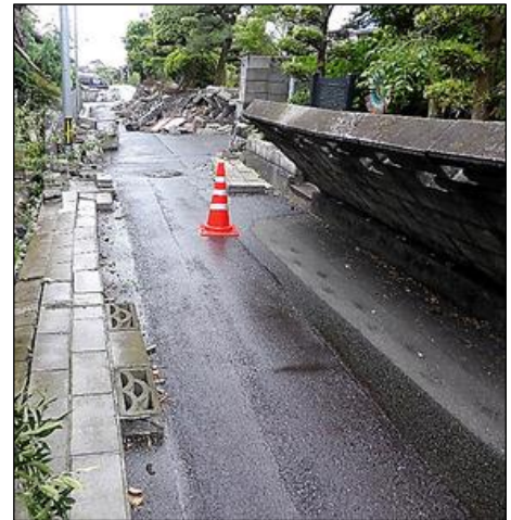
図 26 熊本地震でのブロック塀の倒壊
