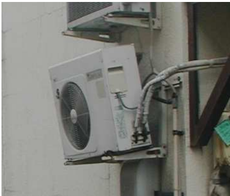
外れそうなエアコン室外機
