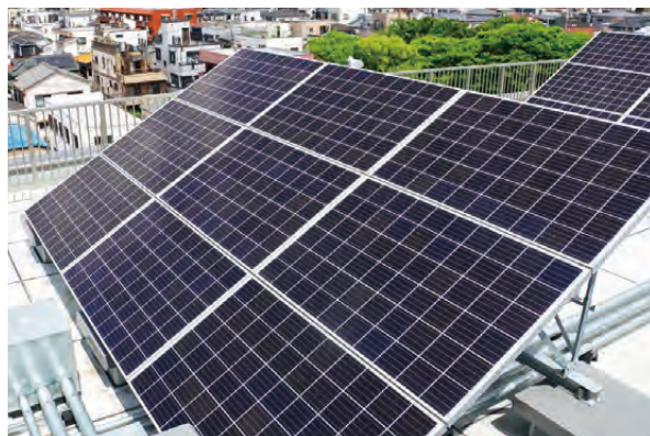
松島コミュニティ会館の屋上に設置している太陽光パネル
