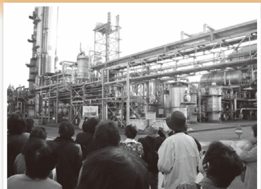
ガス化リサイクル施設
