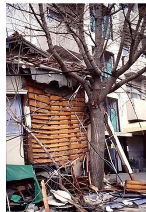
倒壊しそうな家屋を樹木が支え、がれきが道路にせり出すことを防いだ（出典：神戸新聞NEXT, 2022/1/16, 人と自然博物館中瀬館長提供）
