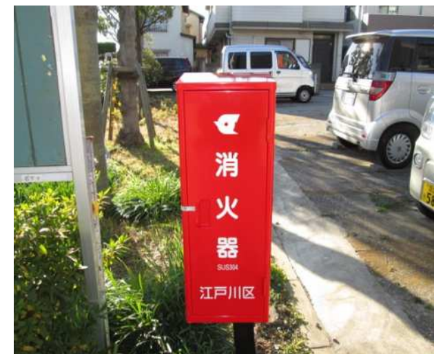
地域配備消火器
