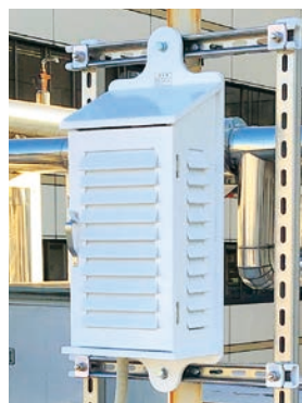
大気中のCO 2 濃度を把握するため、区役所屋上に設置されている二酸化炭素濃度測定器
