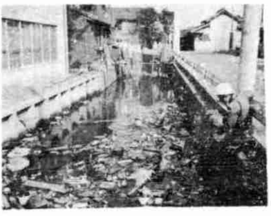
☆尿浄化槽の整備は完全にしましょう。 ☆工場廃液は、完全に処理しましょう。 ☆毒物、薬品類の使用は、川や用水路に不測の事故で薬品などが流出しないよう常に点検しましょう。
