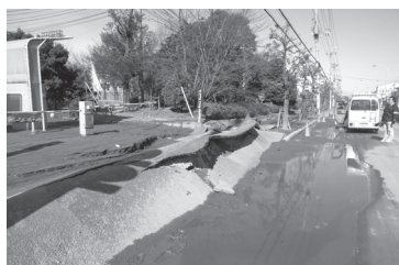
▲液状化した道路（浦安市提供）
