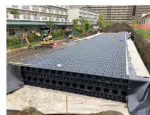
東部交通公園に整備された雨水貯留槽
