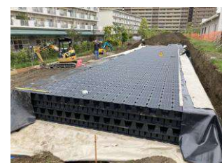
東部交通公園に整備された雨水貯留槽
