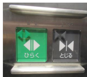
西葛西駅 エレベーター操作盤
