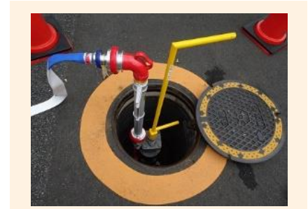
スタンドパイプ
