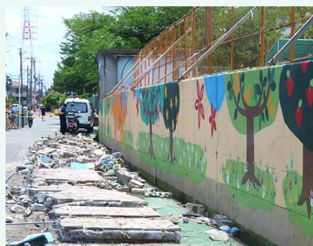
大阪府北部地震(平成 30 年)
