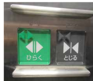
西葛西駅 エレベーター操作盤
