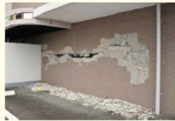
大きく亀裂が入った壁
