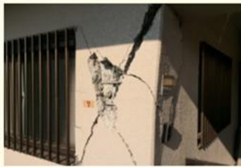
地震特有の亀裂
