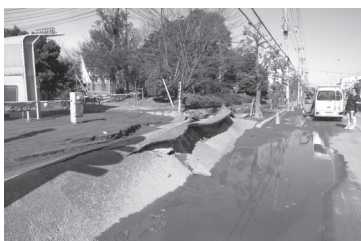
▲液状化した道路（浦安市提供）
