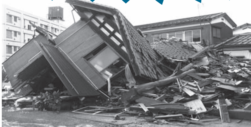
▲新潟県中越地震で倒壊した住宅
