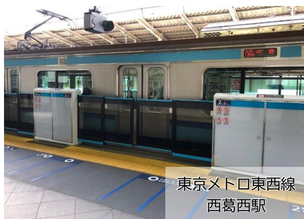
図 各鉄道駅に設置されたホームドア
