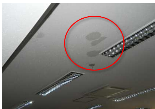
漏水による天井のシミ
