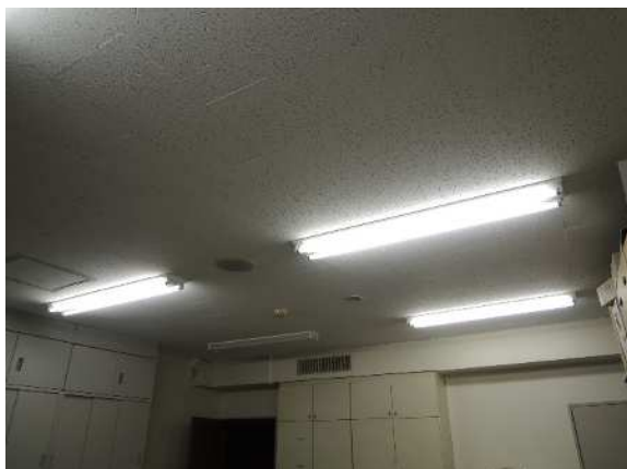
LED 化されていない照明
