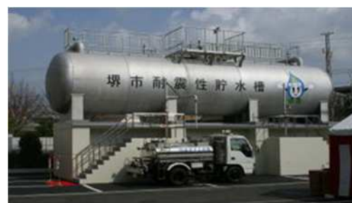
非常用給水設備（大阪府堺市）
