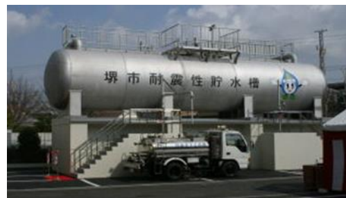
非常用給水設備（大阪府堺市）
