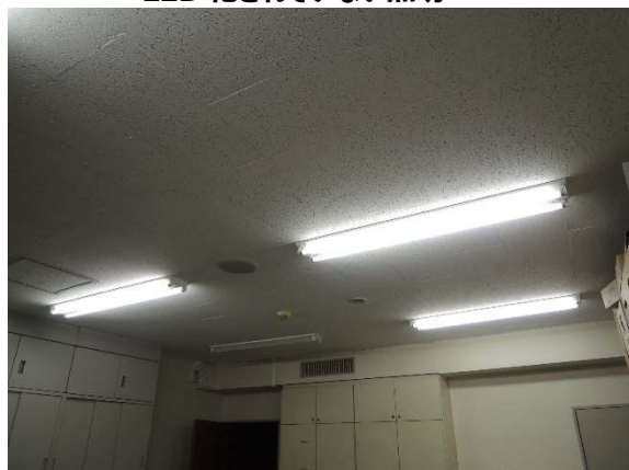
LED化されていない照明
