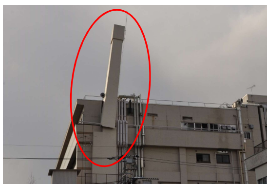
東日本大震災による被害 (煙突の損傷)
