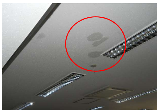
漏水による天井のシミ
