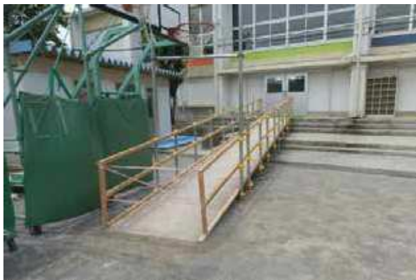
仮設スロープ(第48投票所 瑞江小学校)
