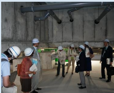
■免震装置（地下）
